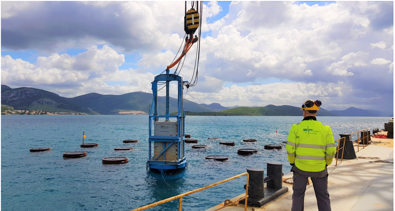
Dinamični obremenilni testi (DOT) s PP54 ; premer pilota=2000mm; lokacija: Most na Pelješac, HR
